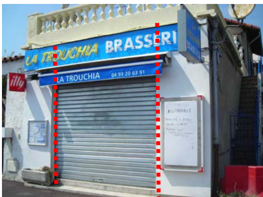
- Enseigne trop large par rapport à la largeur de la baie - panneau d'affichage surdimensionné - Rideaux métallique plein : à peindre
