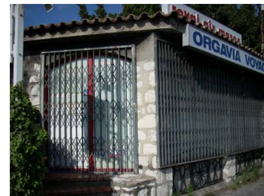
La grille dénature l'architecture de la façade : à éviter
